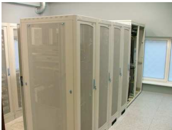
Zdjęcie nr 2. Pomieszczenia serweroni KWP w Poznaniu
